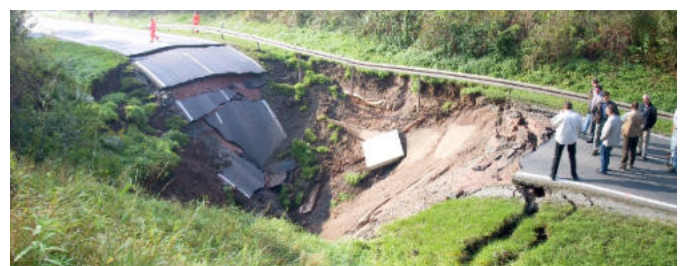
Abb. 18 Straßenschäden durch Erdfälle, Zerspalten, ehemalige B 180 Zustand 2001. Foto: LAGB
