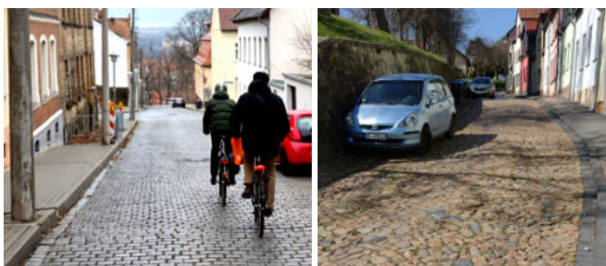
Abb. 28 Teilweise schlechte Oberflächen: Kupferschlacke-Pflaster (Bsp. Hessestr.): holprig und bei Nässe rutschig oder Lesesteinpfaster (Annenkirchplatz)
