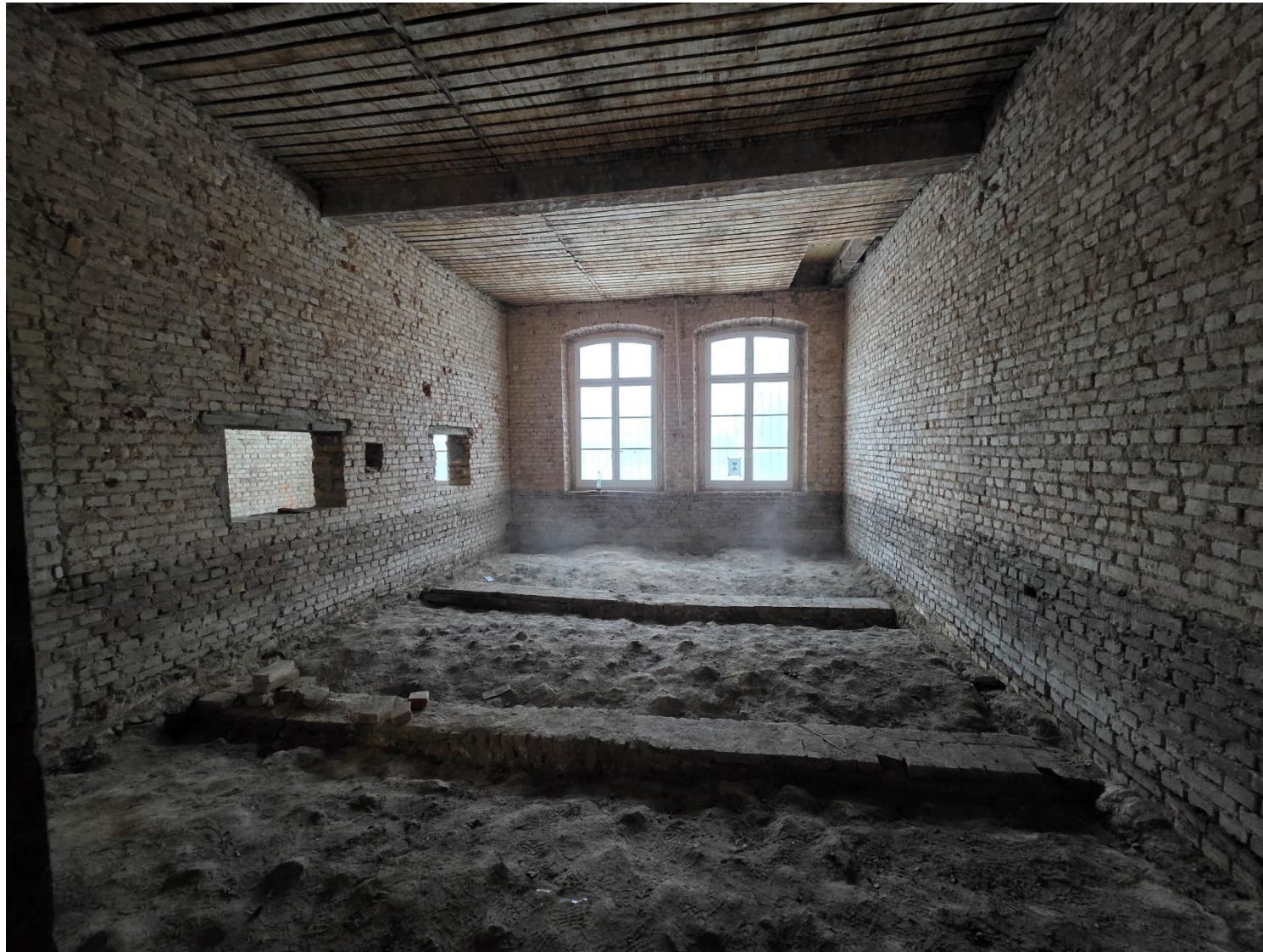
Beräumtes EG und Blick auf die Gewölbedecke und die tragenden MW-Bögen des KG
